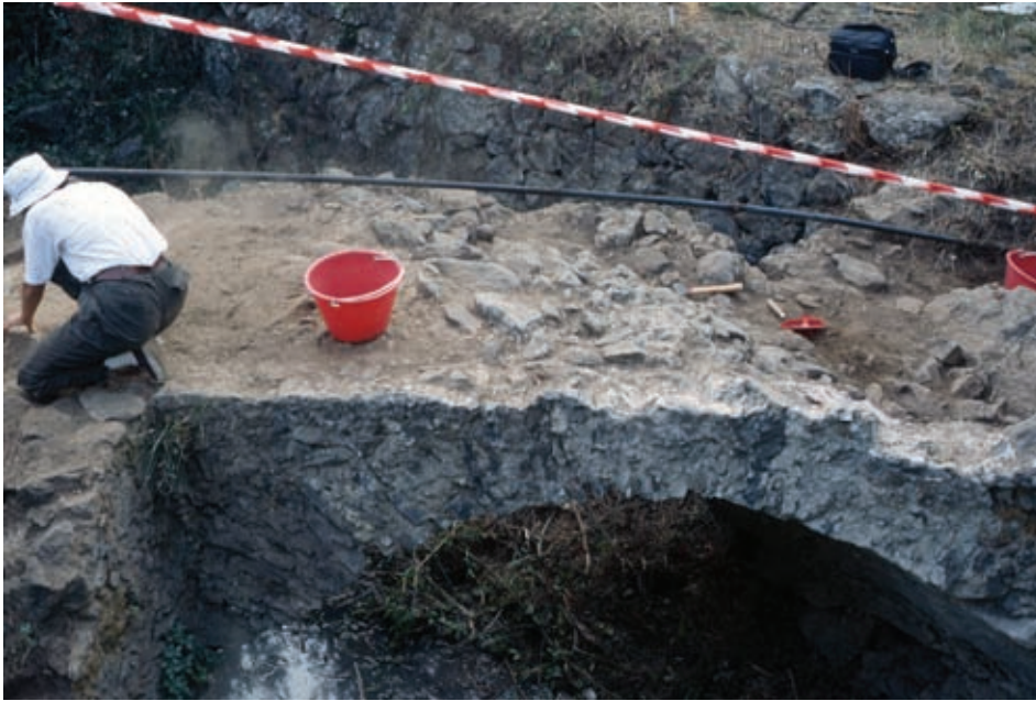
Veduta d'insieme del Ponte di Sofia sito nel Comune di Argusto. La struttura presenta, all'atto del rilievo eseguito, un orientamento in asse N-S con misure in pianta di circa 3,50 mt per 2,00 di larghezza. Lo spessore, in chiave di voltè di 40 cm per un'altezza massima da questa al letto attuale del torrente attraversato di c.a 2 mt.
